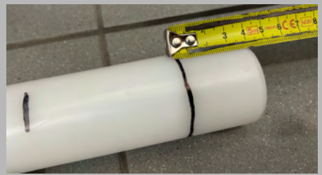
Figuur 14: Zaag het verschil (gemeten in Figuur 13) van de achterkant van de leidingen af.
